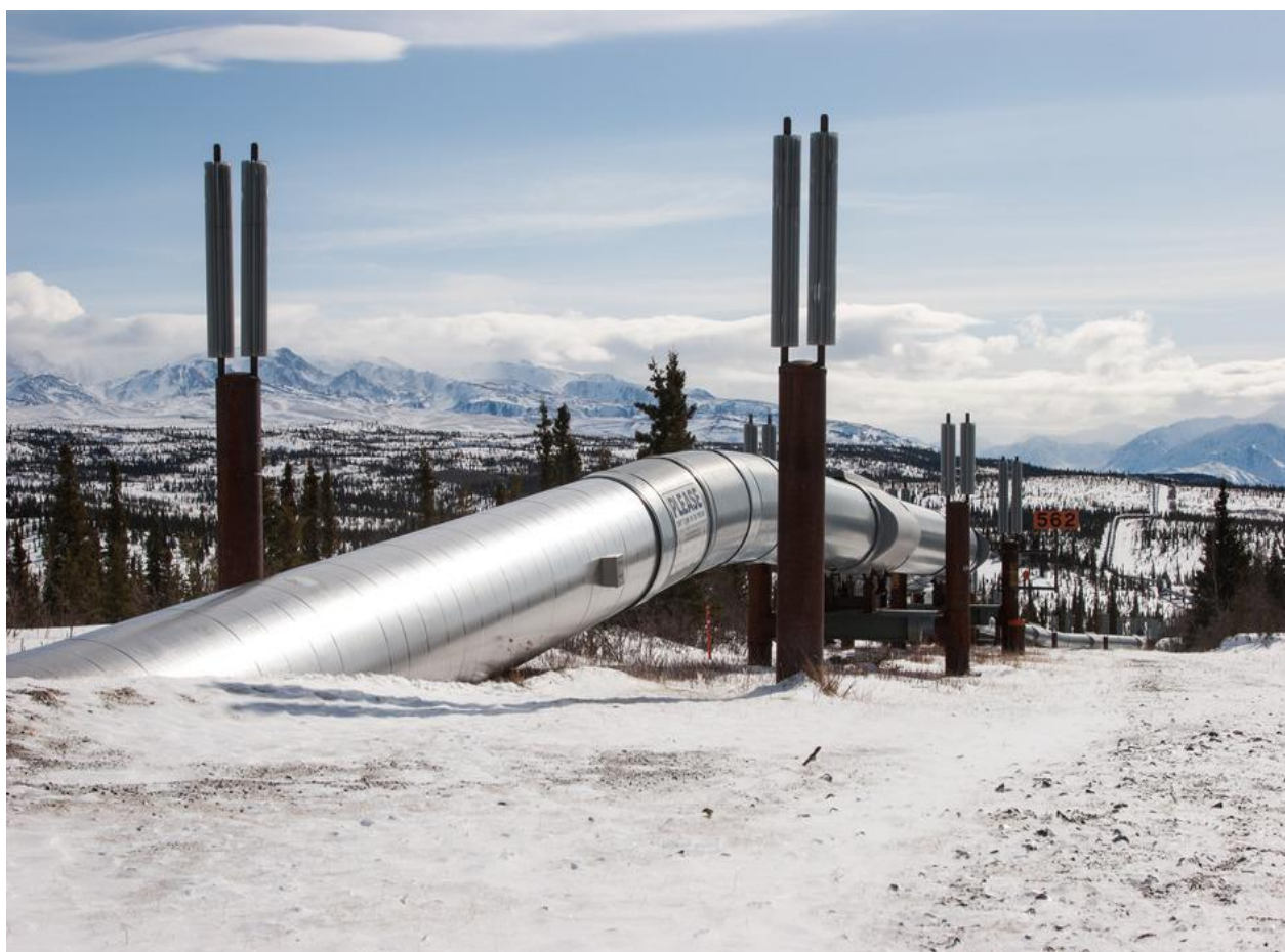
Рисунок 3.7 – Трубопровод на винтовых сваях
