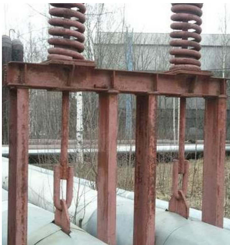
Рисунок 3.2 – Подвесная опора для трубопроводов теплотрасс
