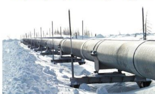
Нефтепровод «Ванкор – Пурпе»
