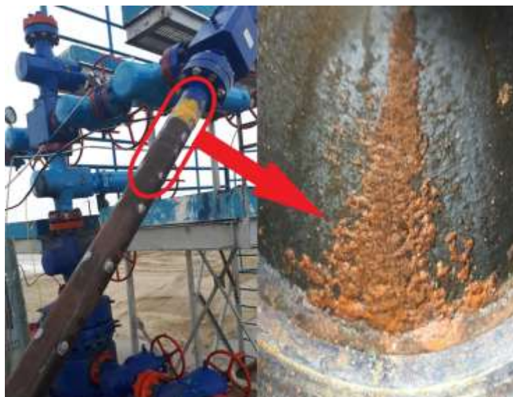
Рисунок 35 – Демонтированный участок трубопровода и следы коррозии по нижней образующей трубопровода
