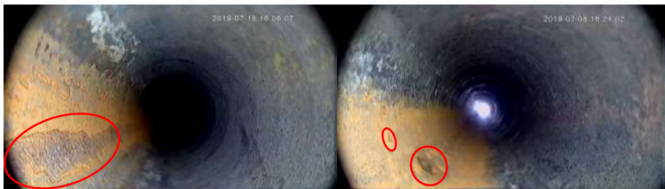
Рисунок 22 – Типичные коррозионные повреждения, выявляемые при видеоэндоскопии
