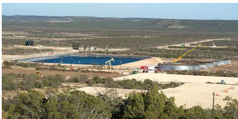
Рисунок 2.39 — Полигон по переработке и подготовке воды ГРП в компании Apache Corporation [72]
