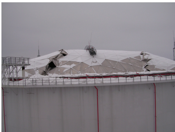
Рисунок 15 – Общий вид резервуара с разрушенной купольной крышей
