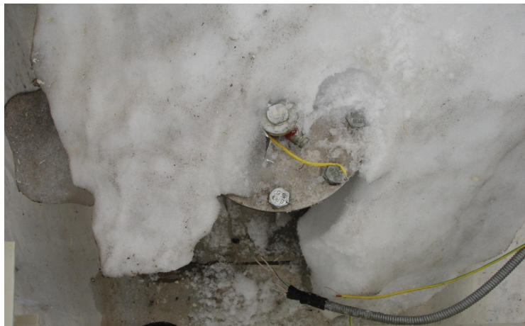
Рисунок 4.22 – Повреждение (обрыв кабеля) датчика аварийного уровня
