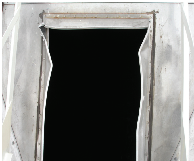
Рисунок 4.23 – Повреждение смотрового люка купольной крыши в результате схода снега
