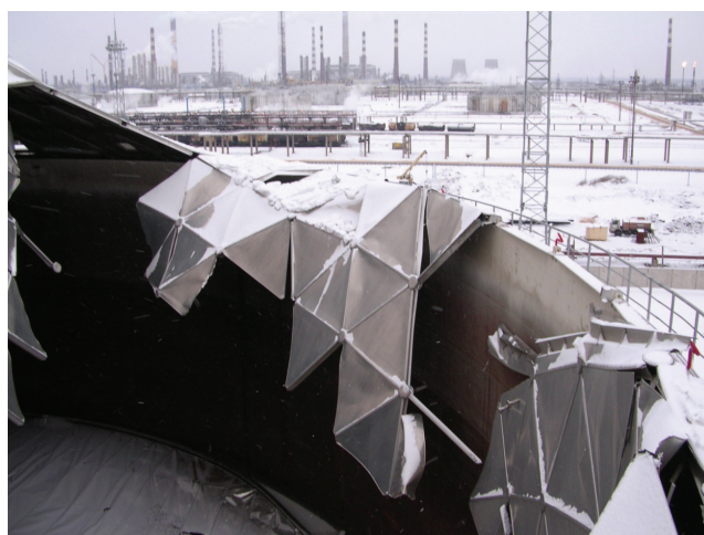
Рисунок 4.17 – Обрушение купольной крыши резервуара в городе Кириши
