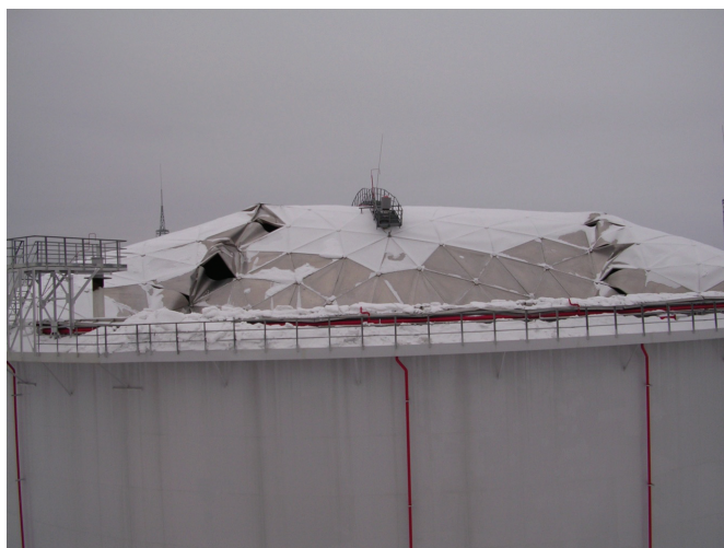
Рисунок 4.16 – Общий вид резервуара с разрушенной купольной крышей
