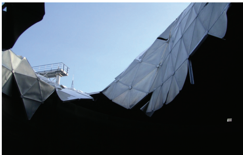
Рисунок 4.18 – Вид на обрушившуюся кровлю изнутри резервуара
