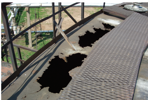
Рисунок 2.17 – Разрушенные под действием коррозии элементы кровли резервуара
