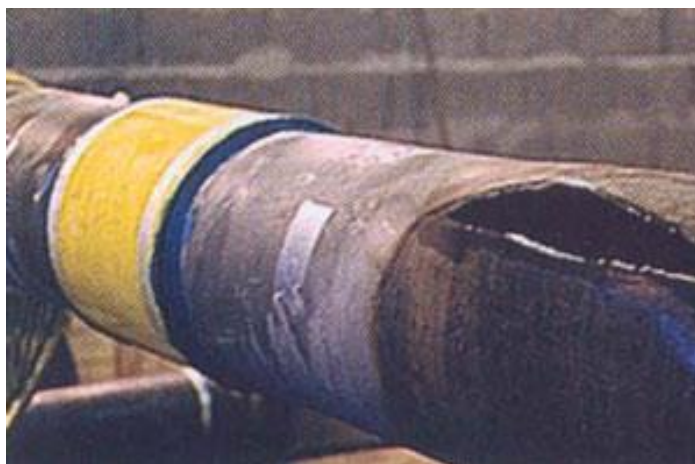
Рисунок 1.13 – Возникновение дефекта рядом с ремонтной муфтой [42]
