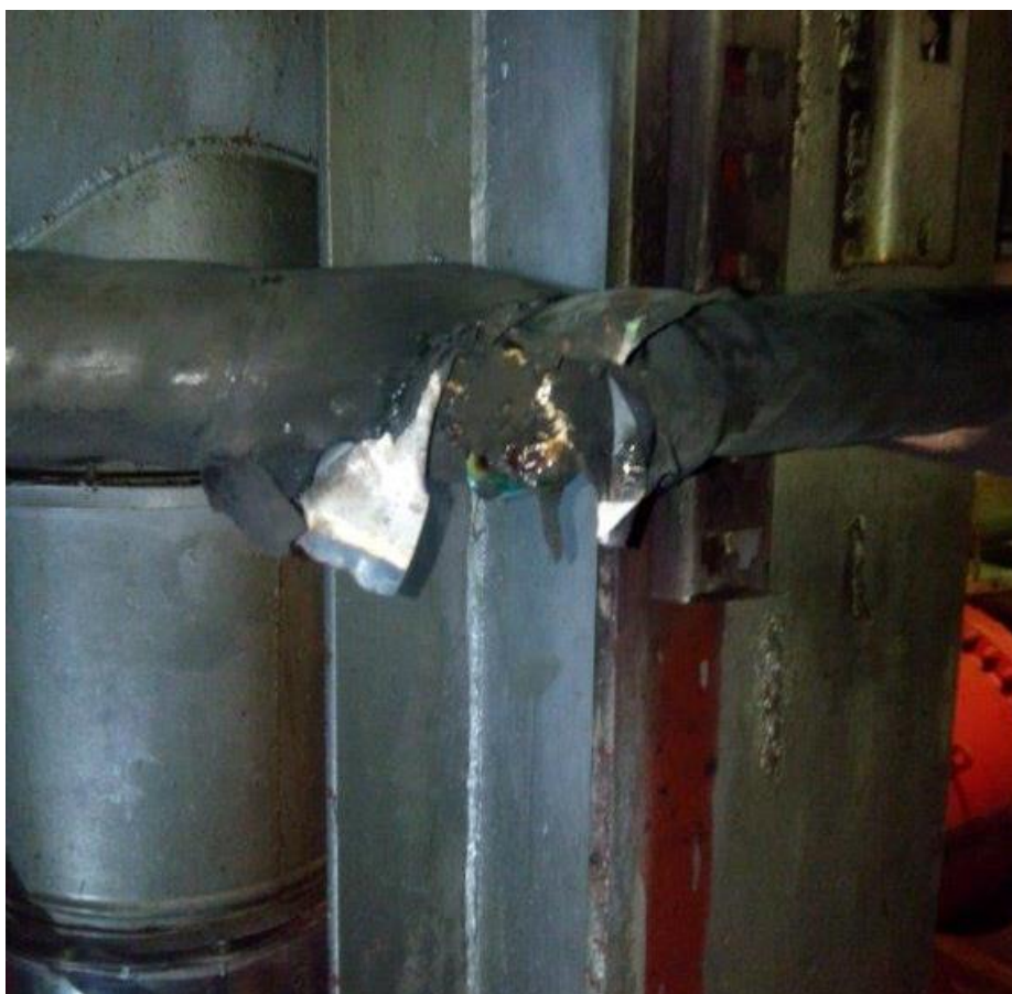
Рисунок 1.8 – Пробой силового кабеля среднего напряжения на месте изгиба
