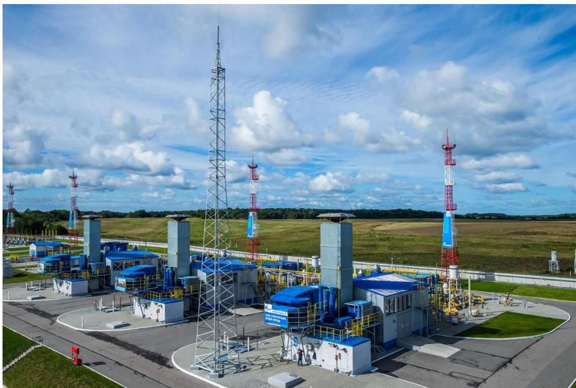
Рисунок 1.4 – Калининградское подземное газохранилище
