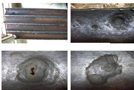
Рисунок 1.4 – Трубопровод Ø114 мм из стали 20
