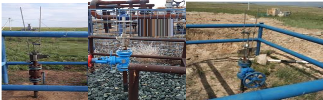
Рисунок 4.1 – Установка узлов контроля коррозии (УКК)
