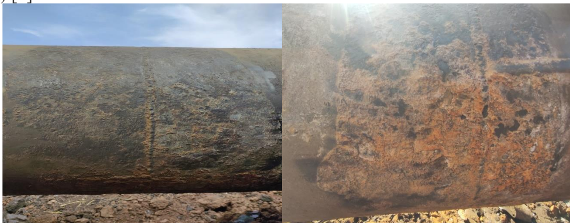
Рисунок 1 - Проявление коррозии под битумной изоляцией на магистральном нефтепродуктопроводе
