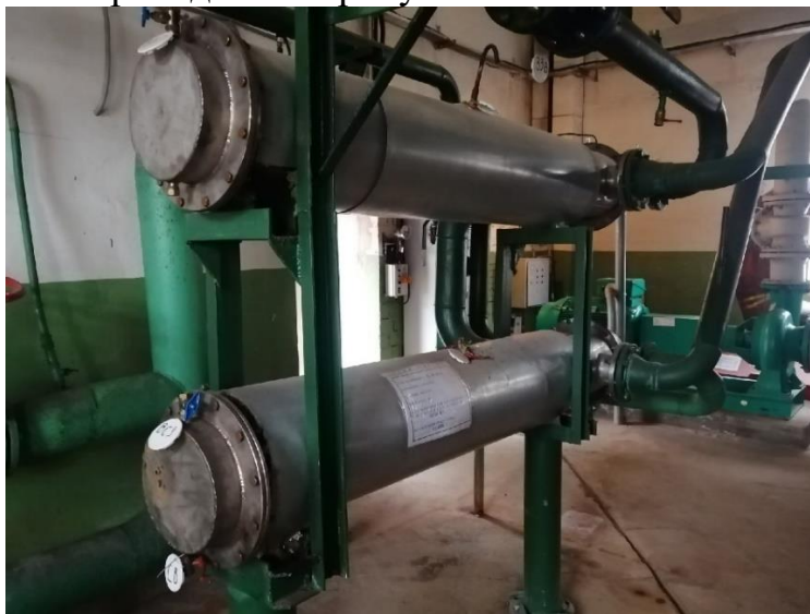
Рисунок 1 – Кожухотрубчатый ТОА с трубками с накатом, установленный на ЦТП 8
