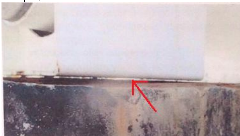
Рисунок 1 - Пример просадки скользящей опоры
