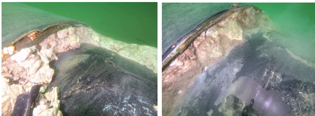
Рисунок 1 - Примеры повреждения ледовой экзарацией покрытия газопровода в области монтажных кольцевых соединений труб
