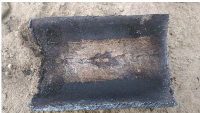
Рисунок 3 – Фрагмент трубы с ручейковой коррозией на нефтесборном трубопроводе
