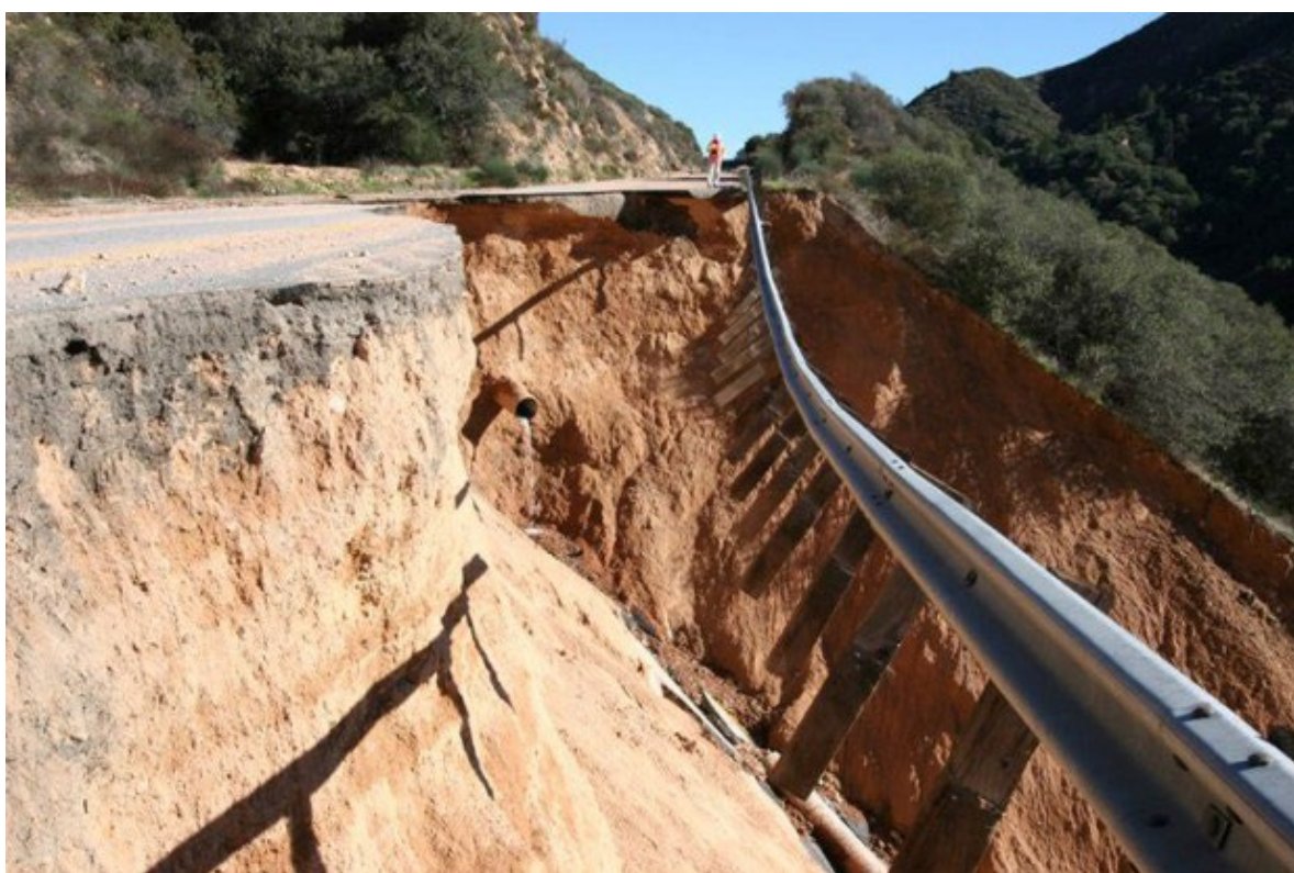
Рисунок 1 – Внешний вид оползня
