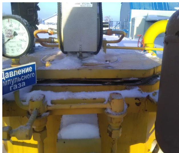
Рисунок 2 – Выдавливание штока шарового крана вследствие обледенения накопленной жидкости в колонне
