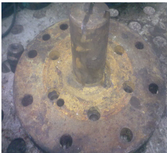
Рисунок 1 – Образование коррозии на фланце шарового крана вследствие накопленной жидкости в колонне
