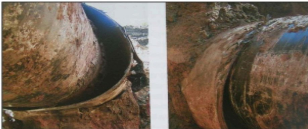
Рисунок 1 – Деформация и смещение защитного кожуха газопровода
