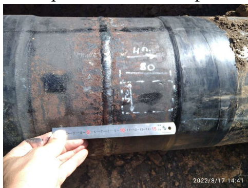
Рисунок 3 – Вмятина на расстоянии 20 мм от поперечного сварного шва ( l=80 мм, b=50 мм, h=2 мм, минимальная толщина стенки в зоне дефекта 9,3мм)
