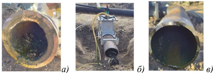
Рисунок 1. Удаление ТСО/АСПО из промыслового нефтепровода АО «Грознефтегаз» (Ø108 мм): а) – ТСО/АСПО в нефтепроводе; б) – оснастка установки и момент удаления ТСО; в) – нефтепровод после обработки
