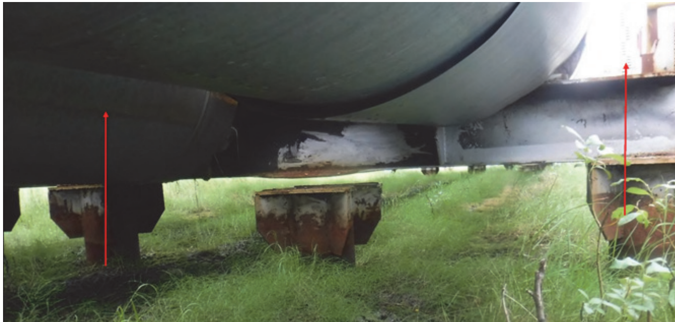
Рисунок 1. Точечные деформации конструкций фундаментов эстакад
