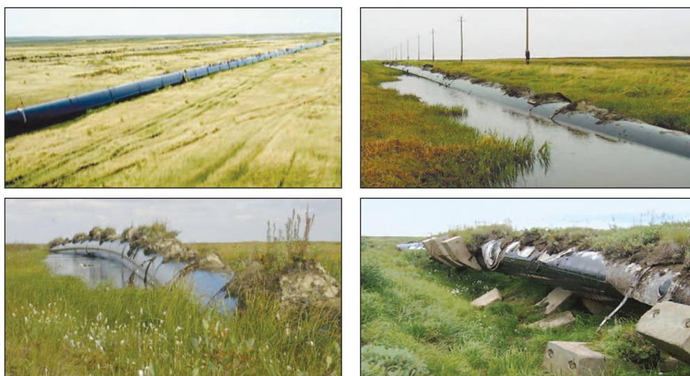
Рисунок 1.8 – Нарушения проектного положения газопроводов на мерзлоте Надымского линейного производственного управления [133]
