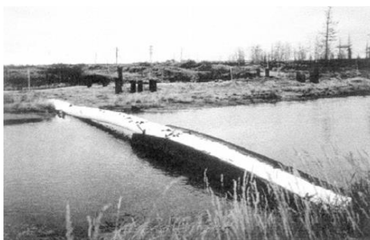
Рисунок 1.11 – «Холодный» конденсатопровод диаметром 325, вытолкнутый из подводной русловой части р. Марелова-Яха [136]
