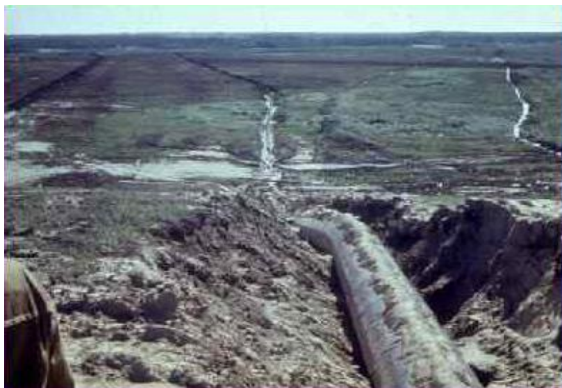
Рисунок 1.21 – Термоэрозионный размыв грунта на участке подземной прокладки трубопровода. Газоконденсатное месторождение Медвежье
