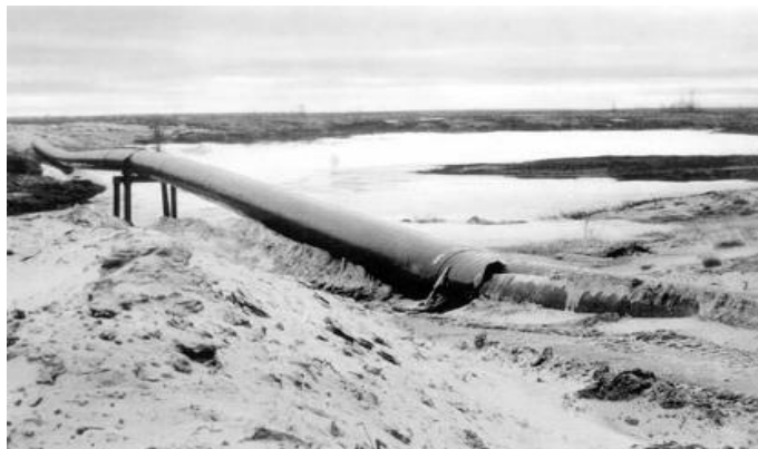
Рисунок 1.1 – Выдавливание свай надземного перехода газопровода через р. Ен-Яха
