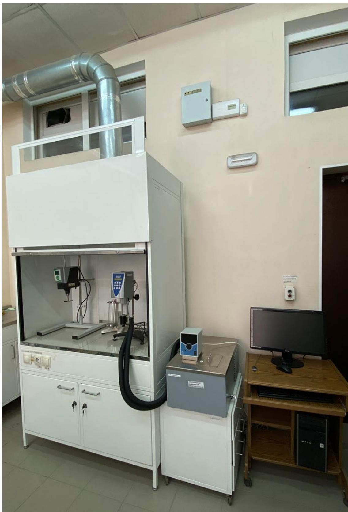
Рисунок 5.9 – Внешний вид основного оборудования, входящего в состав межкафедральной лаборатории факультета трубопроводного транспорта
