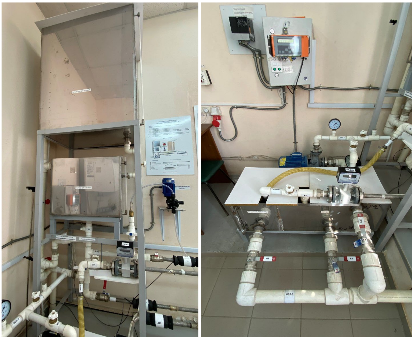
Рисунок 5.5 – Питательная и напорная емкость, насос центробежный с ЧРП и другое оборудование комплектации установки
