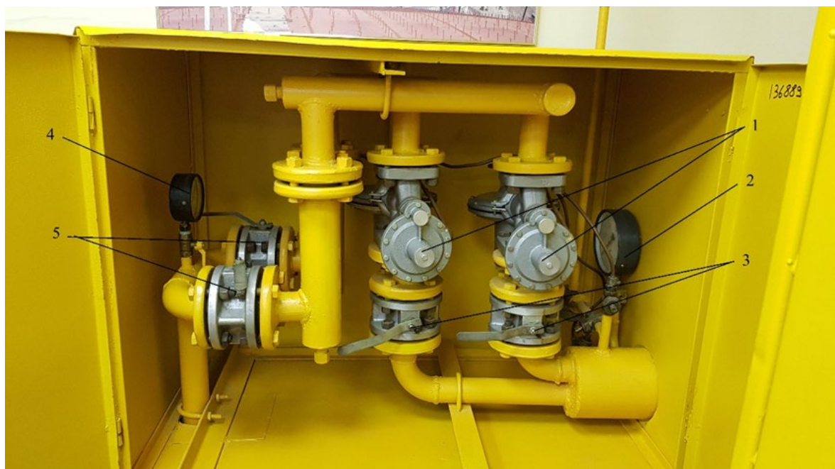
1 – регуляторы давления газа РДНК, 2,4 – манометры, 3,5 – запорная арматура Рисунок 1.36 – Шкафной газорегуляторный пункт (ШГРП)
