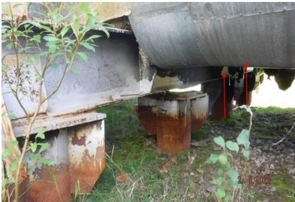
Рисунок 1 – Деформации опорных конструкций эстакад
