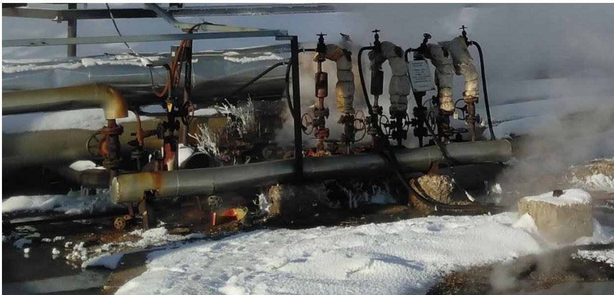
Рисунок 1 – Пароконденсатные системы НПЗ (вынужденный сброс на рельеф, причина: пролетный пар увеличивает противодействие в конденсатопроводе, препятствуя отводу конденсата)
