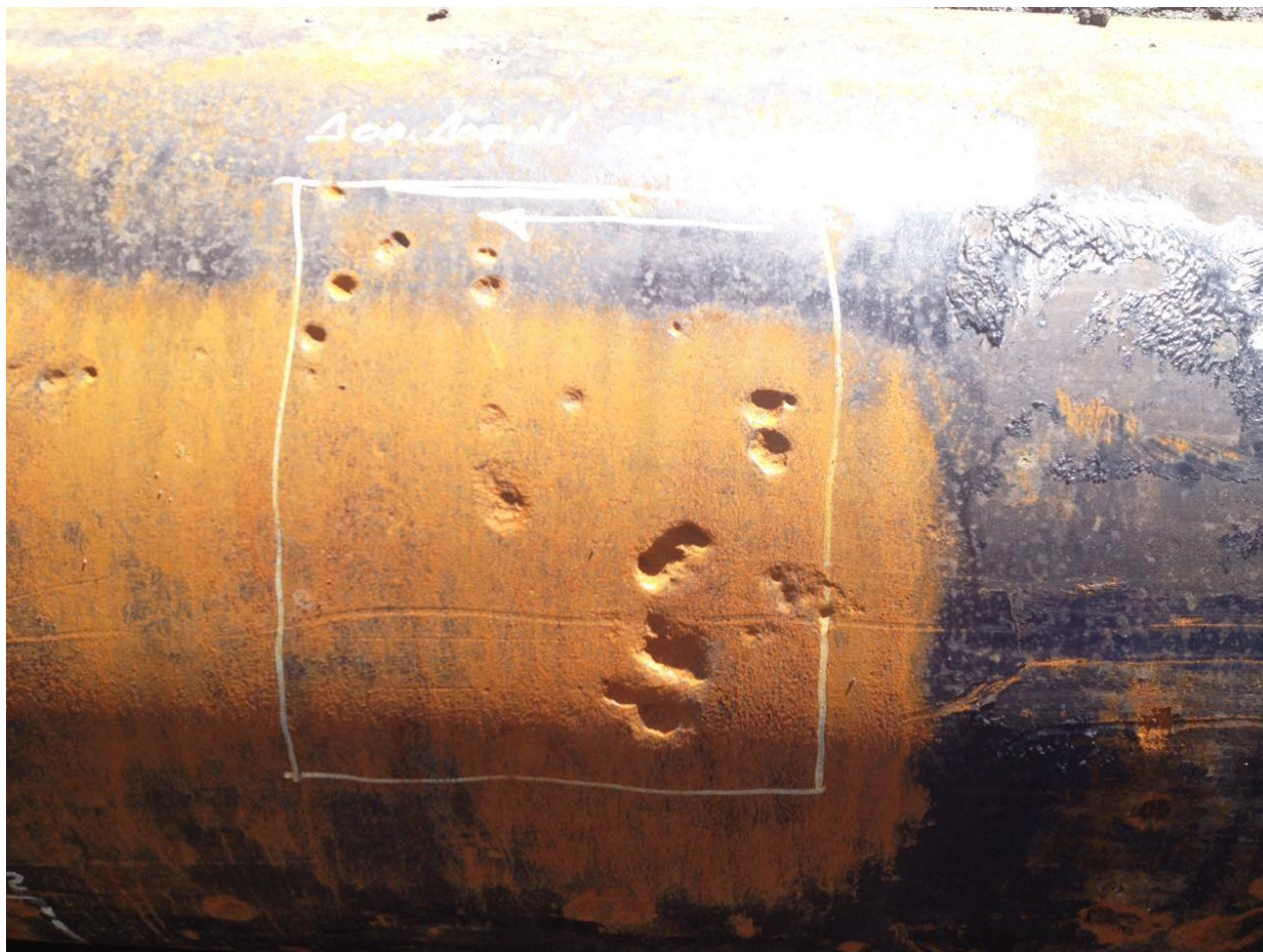
Рисунок 1 – Внешние дефекты стенки трубы образованные в следствии опасного влияния постоянных блуждающих токов
