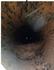
Рисунок 1 – Отложения в вырезанной катушке из трубопровода.
