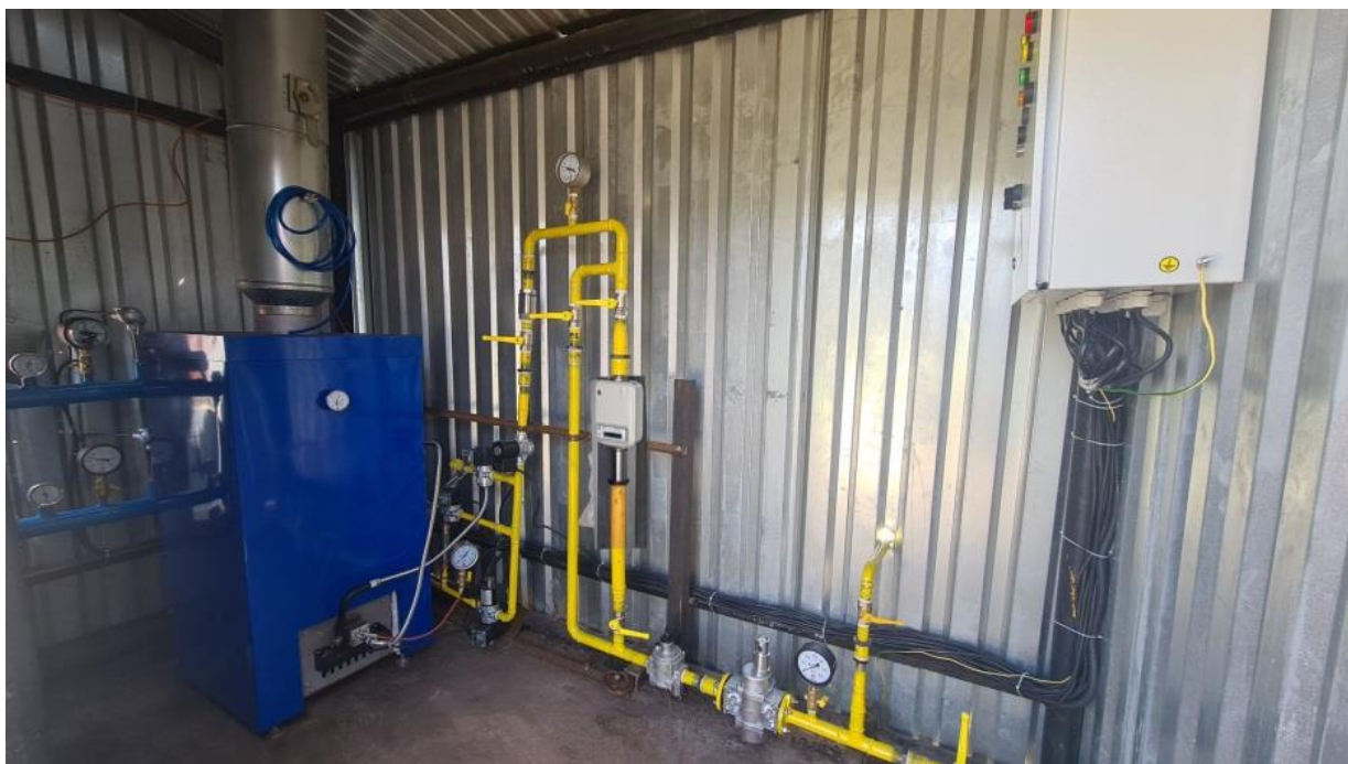
Рисунок 1 – Фотография котла КВ-ЦБ расположенного на установке подготовки нефти
