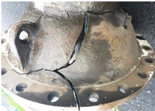
Рисунок 1 – Вид крышки с трещиной во фланцевой и купольной части
