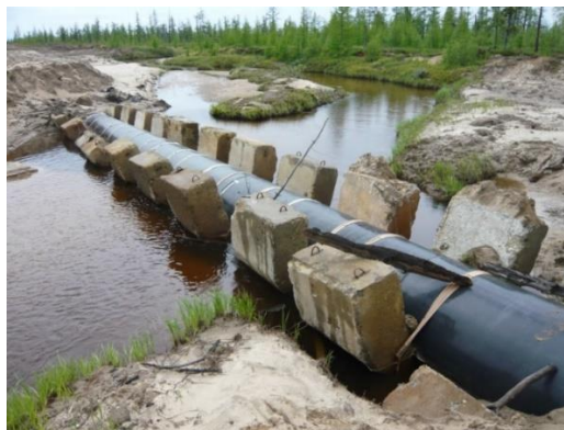
Рисунок 1 – Всплытие подземного трубопровода вследствие растепления многолетнемерзлого грунта [1]
