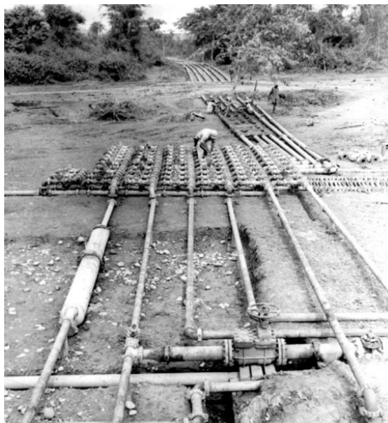
Рисунок 1.7 – Коллекторная задвижка (сентябрь 1944 года) на трубопроводе неподалеку от города Мьиткина в Бирме
