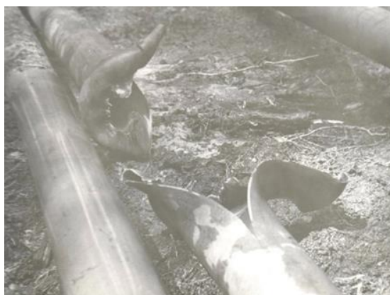
Рисунок 1.19 – Труба после взрыва на трассе трубопровода
