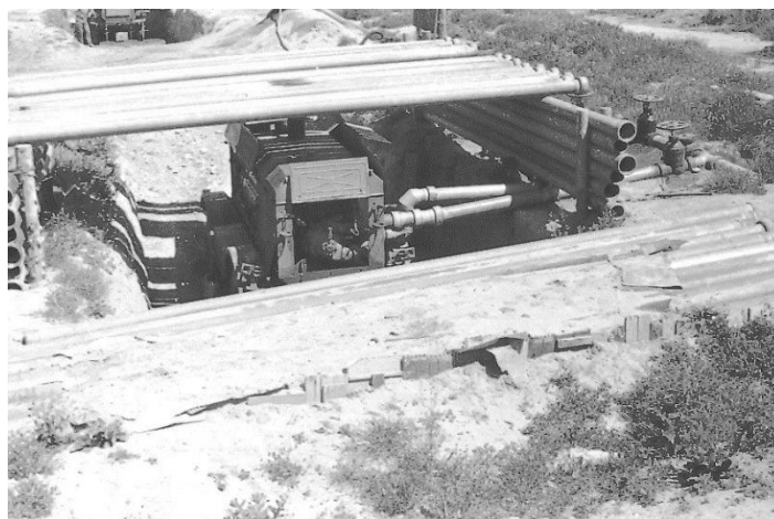
Рисунок 1.18 – Передвижная насосная установка в укрытии
