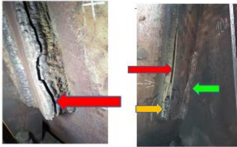
Рисунок 3.44 – Фото дефектов опор коксовых камер УЗК УНХ [179]
