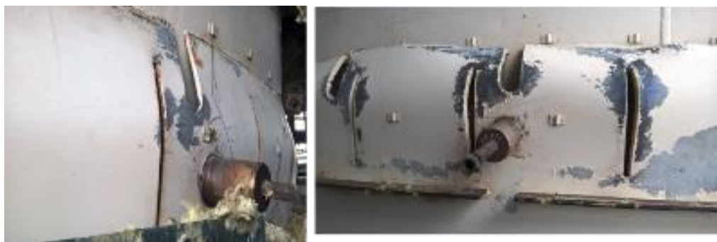
Рисунок 3.46 – Фото потери формы опорной обечайки коксовой камеры [182]
